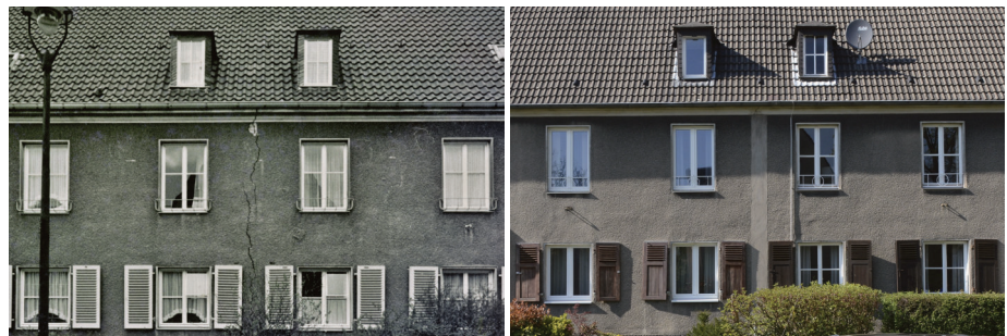
Abbildung 3.8: GLA · BR · 01 Bergschäden am Wohnhaus einer ehemaligen Werkssiedlung. Vermutlich wurde das große Doppelhaus privatisiert, denn es wurden in beiden Haushälften unterschiedliche neue Fenster eingebaut. Das Äußere des Hauses ist im Wesentlichen unverändert, die Bergschaden-Risse wurden jedoch beseitigt. (Quelle: Scharioth und Schräpler 2017)
