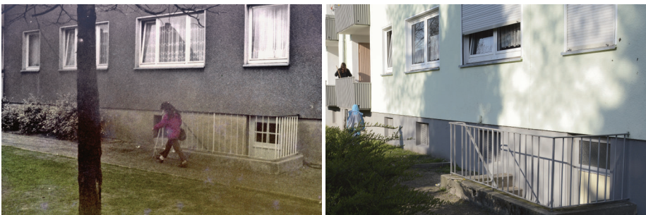
Abbildung 3.30: GLA · BR · 03 Detail des Hauses einer Nachkriegssiedlung des sozialen Wohnungsbaus. Die Sanierung des Hauses erscheint wohnwertorientiert, aber nicht umfassend. Das durchfeuchtete Mauerwerk des Kellerabgangs war 2015 nicht saniert. (Quelle: Scharioth und Schröppler 2017)
